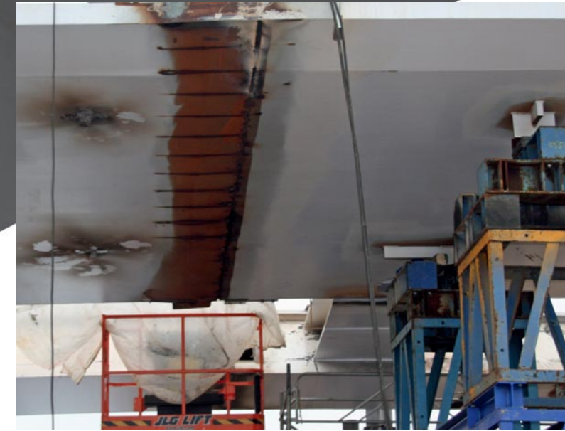
Hovenring Eindhoven in aanbouw, op een punt waar twee segmenten aan elkaar gelast zijn. Rechts is nog de tijdelijke ondersteuning zichtbaar, links de schade die dat oplevert. De buitenste rand van het brugdek ter hoogte van de verbinding (las) loopt wat hoekig, terwijl hij de ronding van het dek moet volgen.
