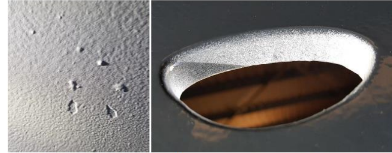
Fouten in metallisatie niet hersteld vóór aanbrengen vervolglagen – overspray
